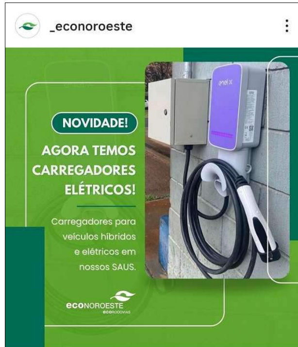
Imagem 58: Divulgação sobre a disponibilização de Carregadores Elétricos (PD: 3).
